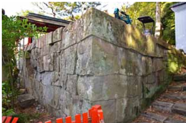
修理前石垣の破損状況
