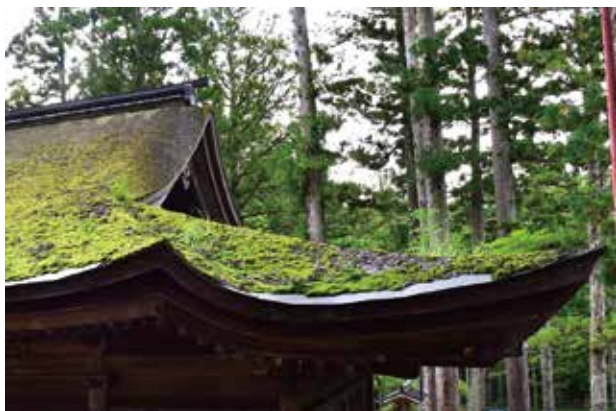
修理前の檜皮屋根の劣化状況
