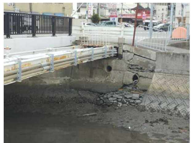
写真4 中津川橋護岸痕跡
