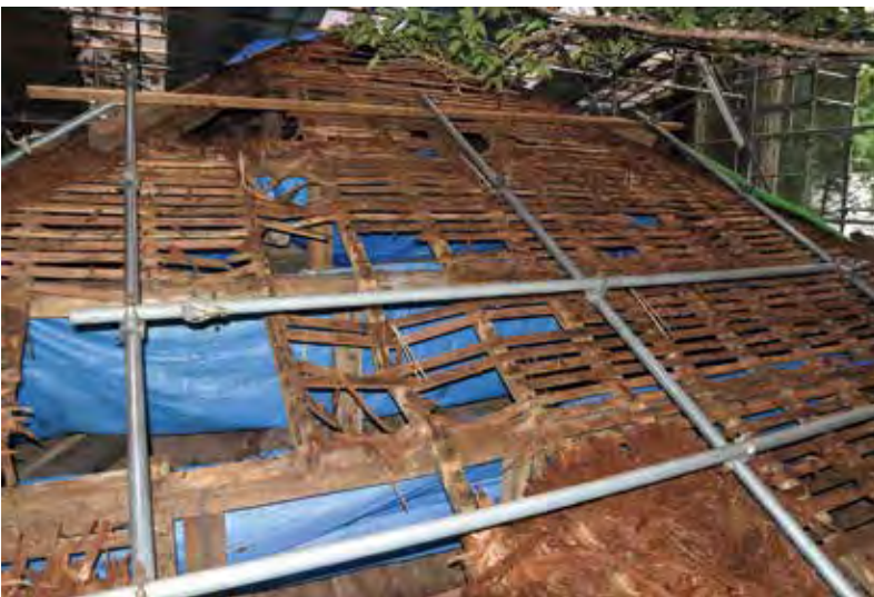
木舞や野垂木の腐朽状況（奥院経蔵）
