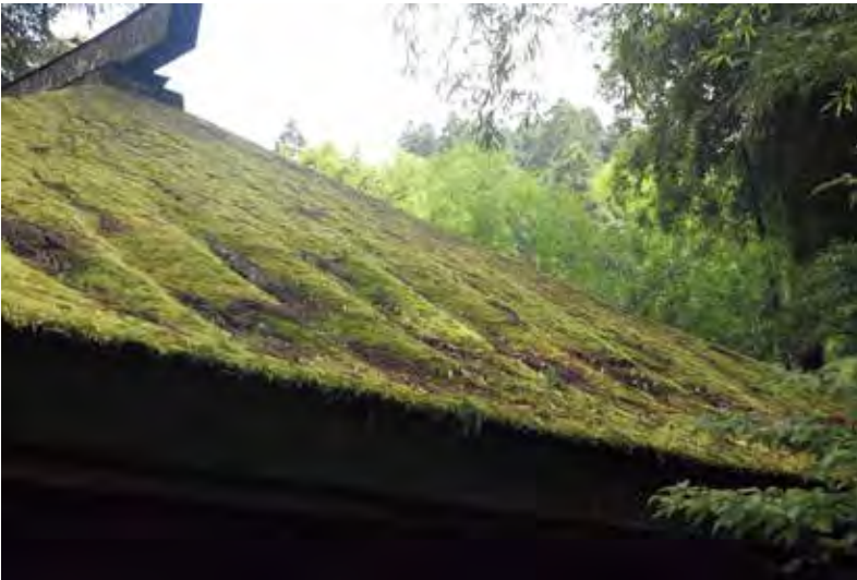
筋状に屋根面が窪んだ状況（金剛三昧院経蔵）
