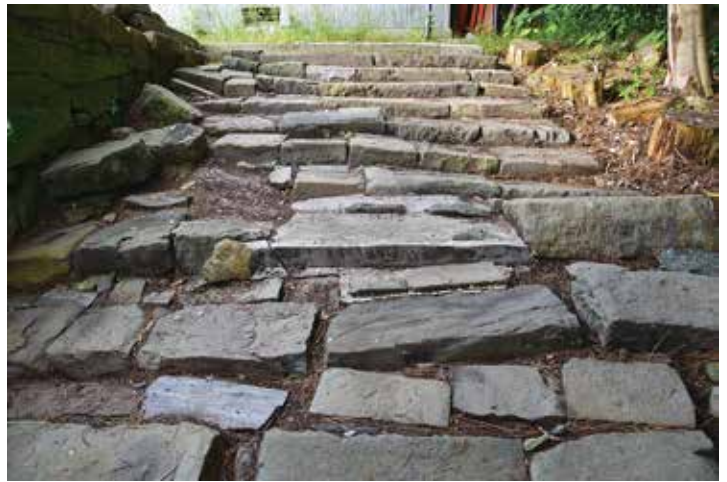
石階段の不陸状況
