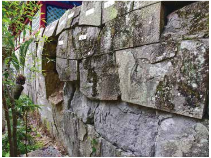
石垣の破損状況
