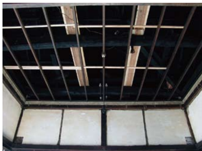
写真2：台所の1室「寺務所」での解体及び修理状況 (漆喰壁の解体範囲は、柱の建て起こしや金具補強のために必要となった部分。)
