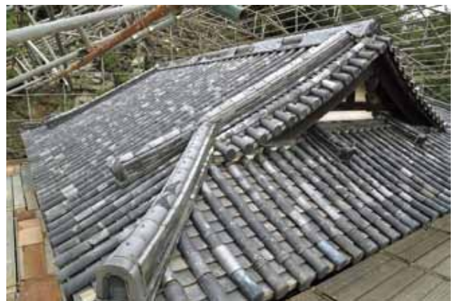
写真 1. 浜座敷屋根の修理前状況（南東）
