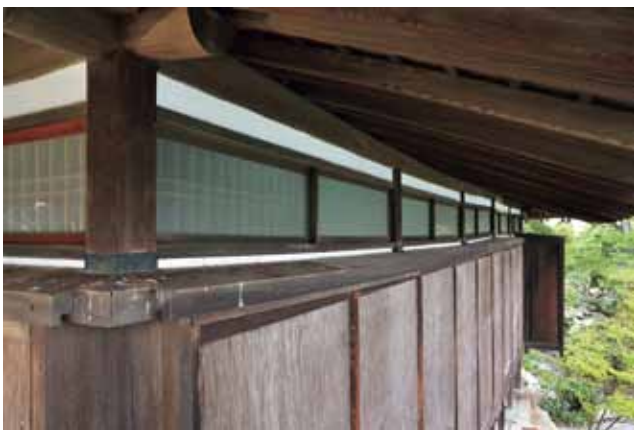
写真 2. 浜座敷広縁部分の軒垂下状況（南東）
