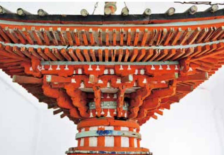
二重軒廻り よく見ると様々な部材が破損している。
