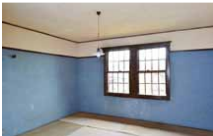
写真 17 修理前の子供寝室
