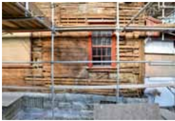
写真1 建物北東、基礎石の沈下および木部腐朽の様子
