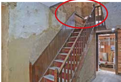
写真8. 主階段北側の内壁に残る改変痕跡
