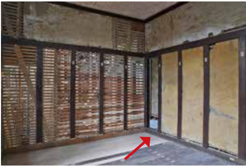
写真5. 事務室北東に存在した通用口（矢印先） 壁面の一區画（内幅45cm分）に扉が付けられていたことがわかりました。
