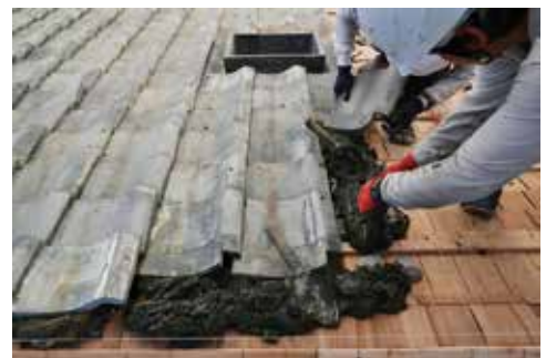
写真2. 屋根土居葺き（上）・瓦葺きの様子 部材は可能な限り再利用しています。
