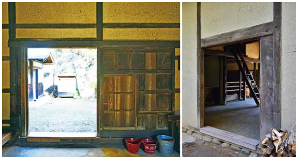
写真5 旧佐々木家住宅（神奈川県・重文）の大戸 差し鴨居は開口部のみに入り、大戸は壁の内側に入る
