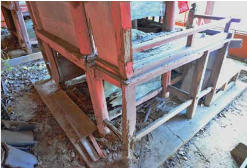
写真2 三社権現（熊野三所権現）の背側面 特に壁板や土台などが蟻害を受けていた
