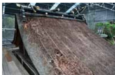
屋根の修理前破損状況（写真1）
