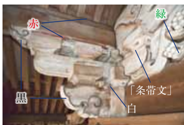
東妻面の塗装痕跡残存状況 (写真7)
