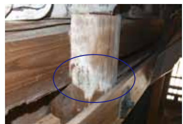
正面長押裏の絵様痕跡残存状況 (写真8)
