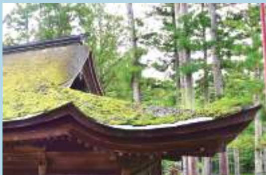
檜皮屋根の腐朽状況
