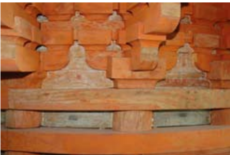
多宝塔上層の塗装掻き落とし状況 昭和修理の番付札のあたり面に旧塗装が見えます。昭和修理で部材は入念に洗われたようですが、番付札を外さないで洗ったため、幸いにして残ったようです。
