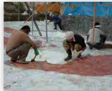
3 ポリエステル樹脂塗布 立体形状を維持するために、シリコン樹脂の上に塗布して、FRP より強化。
