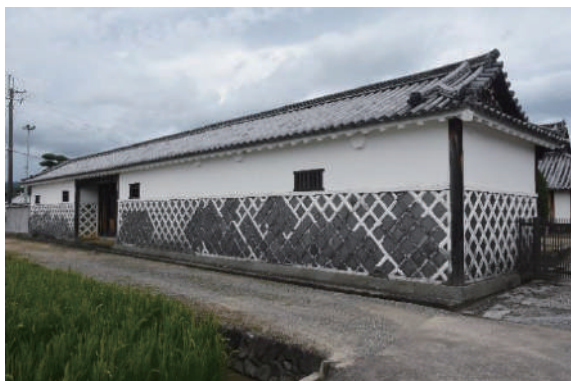
写真2 漆喰の剥落が進んだ修理前の表門
